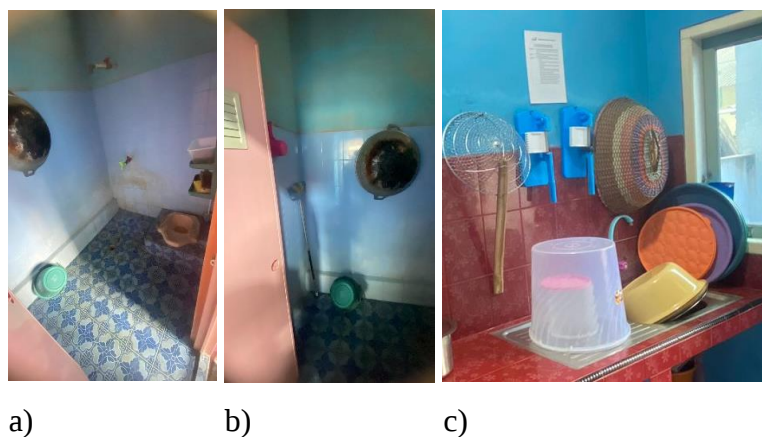
Gambar 12. Kondisi fasilitas higiene seperti toilet dan wastafel tempat cuci tangan
