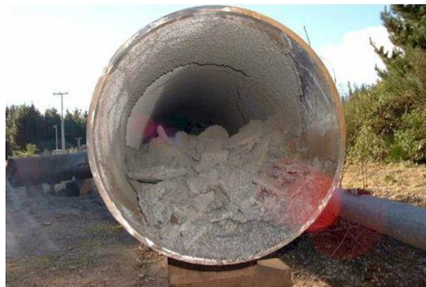
Gambar 5. Silica scaling pada pipa Sumber: pureadvantage.org, 2015
