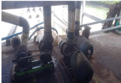
Pompa Air Tandon
