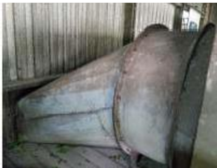
Gambar 4. Penyalur udara (Sumber: Dokumentasi pribadi, 2023)
