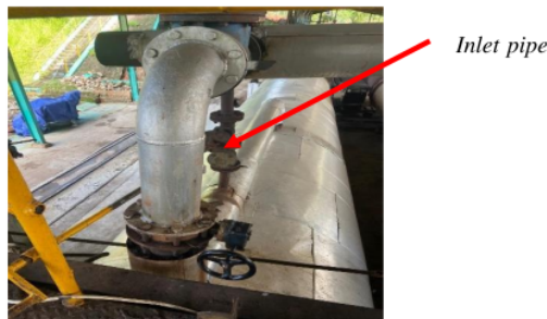
20 Gambar 13. Inlet pipe (Sumber: Dokumentasi pribadi, 2023)
