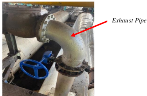
15 9 Gambar 14. exhaust perebusan (Sumber: Dokumentasi pribadi, 2023)
