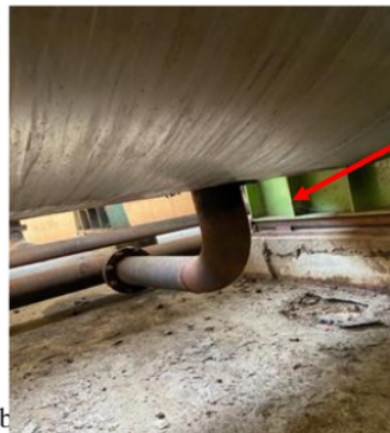
Pondasi air kondensat
