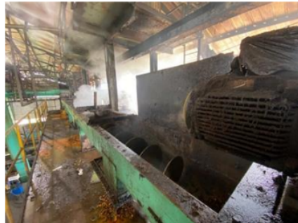
Gambar 11. Distributing Conveyor Sumber: Dokumentasi Lapangan, 2023
