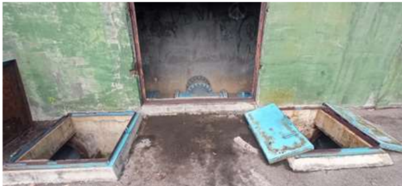
Gambar 10. Reservoir Sumur Putri Sumber: Dokumentasi lapangan di Perumda AM Way Rilau
