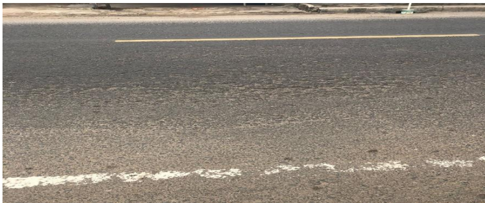
Gambar 2.13 Jenis Kerusakan Pelepasan Butir
