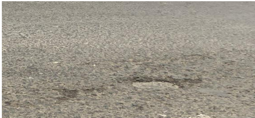
Gambar 2.10 Jenis Kerusakan Lubang
