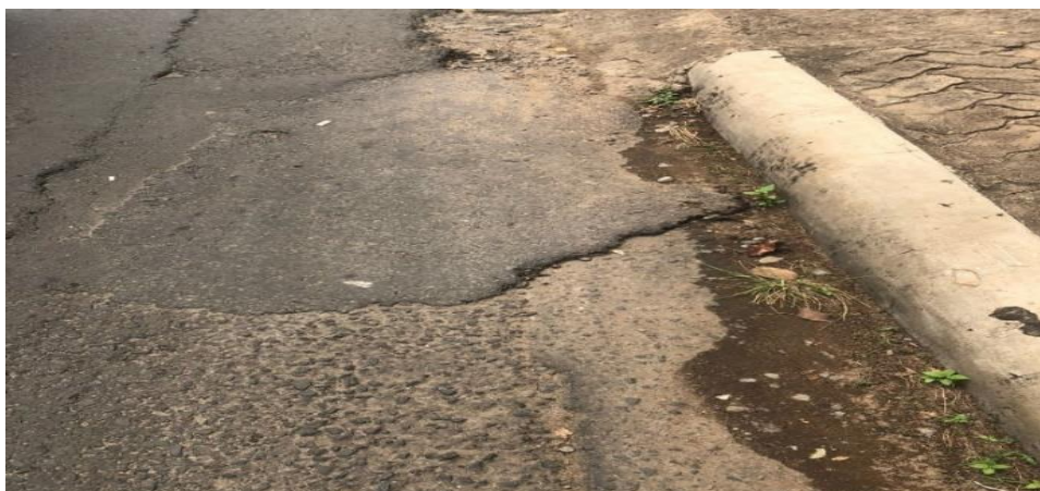
Gambar 2.12 Jenis Kerusakan Sungkur
