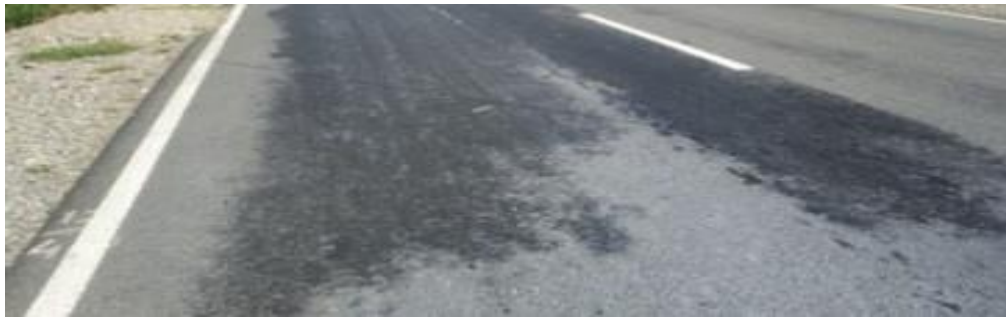
Gambar 2.2 Jenis Kerusakan Kegemukan
