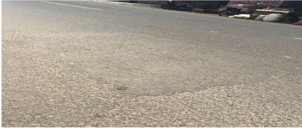
Gambar 2.8 Jenis Kerusakan Tambalan
