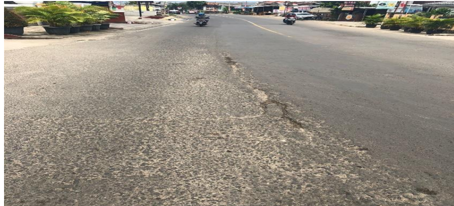
Gambar 2.6 Jenis Kerusakan Retak Memanjang
