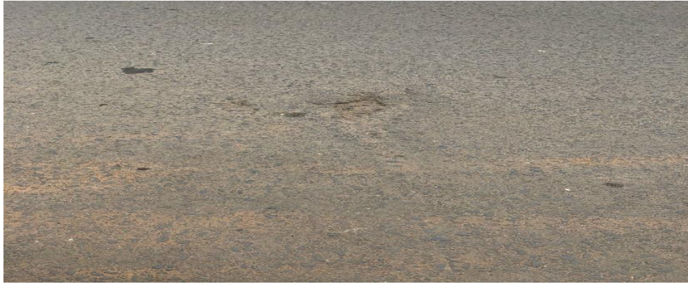
Gambar 2.3 Jenis Kerusakan Keriting
