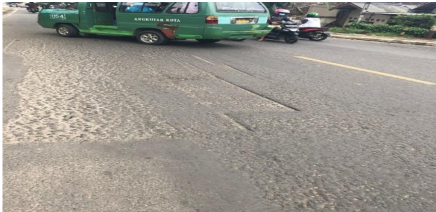
Gambar 2.11 Jenis Kerusakan Alur
