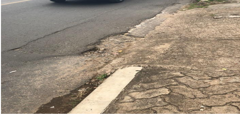
Gambar 2.4 Jenis Kerusakan Retak Pinggir
