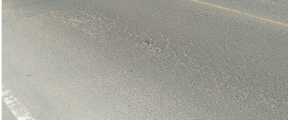
Gambar 2.1 Jenis Kerusakan Retak Buaya
