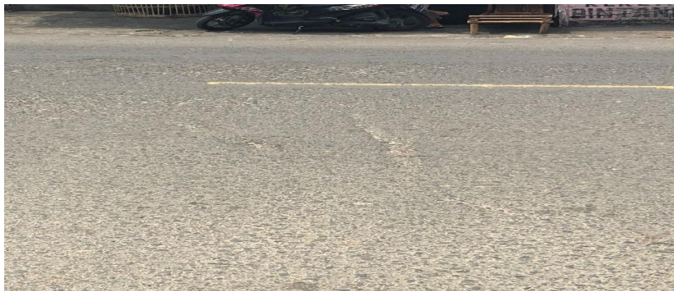
Gambar 2.7 Jenis Kerusakan Retak melintang
