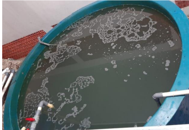
Gambar 1.6 Bak koagulasi Sumber: Dokumentasi lapangan di PDAM Way Rialu
