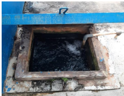
Gambar 1.11 Reservoir Sumur Putri Sumber: Dokumentasi lapangan di PDAM Way Rialu
