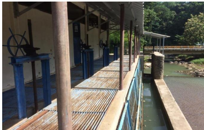
Gambar 1.5 Bangunan penangkap air ( Intake ) Sumber: Dokumentasi lapangan di PDAM Way Rialu
